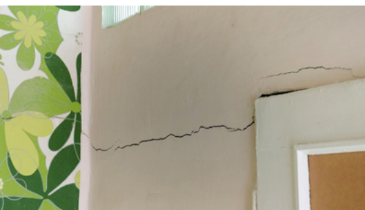
Pękające ściany w Zespole Szkolno-Przedszkolnym nr 3 przy ul. Miodowej 36, fot. Monika Bętkowska
